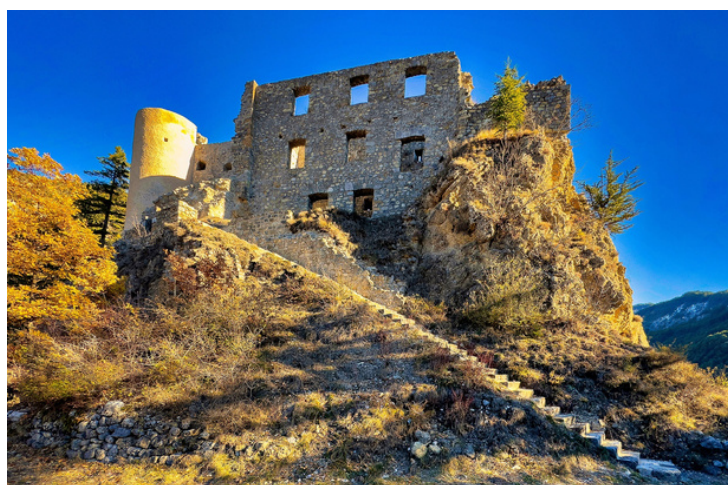
Travaux de consolidation et d'accessibilité du Château Fondation du Patrimoine - Mission BERN
