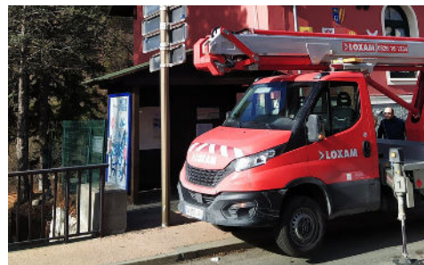
Installation du téléphone satellite au corps des Sapeurs-Pompiers
